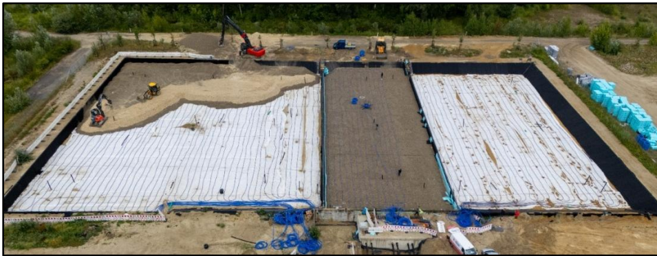
Abbildung 1: INTERSTORES-Saisonalspeicher „Reno-sTES“ in Ingolstadt.
